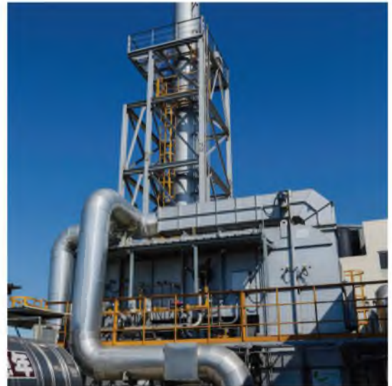
RTO 蓄熱式焚化爐外觀
