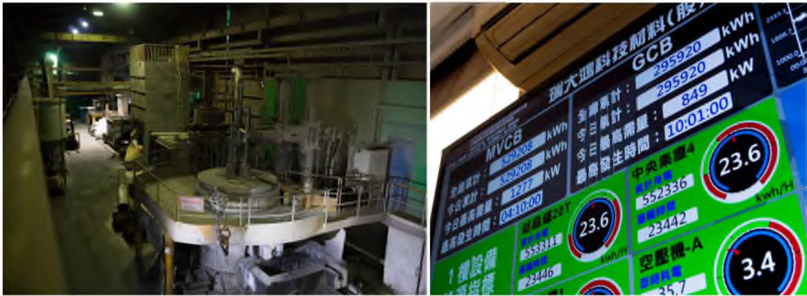
由左至右：廠內的設備皆是購入廠房後進行細部修改；廠內導入能源管理與監視系統，透過平台即時掌握廠內用電狀況。
