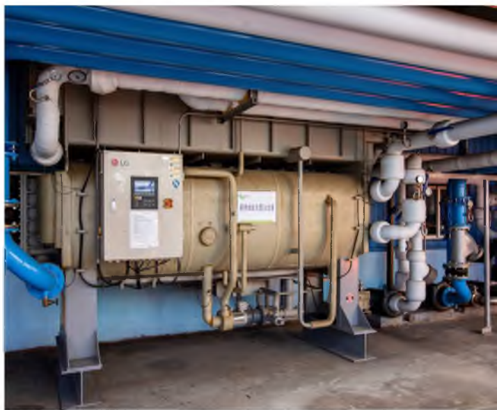
廢熱製冷設備 - 吸附式冰水主機
