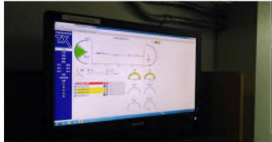
聯陣空壓機聯控系統裝置設備
